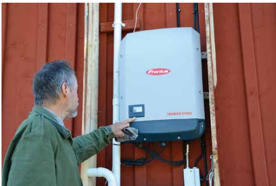
Jens visar växelriktaren som kopplar ihop solpanelerna med elnätet. På mätaren kan man se hur många Kilowatt som levereras i stunden. Systemet är en färdig pakettlösning som ombesörjer att den el som solcellerna ger i första hand går till den egna fastigheten, men att eventuellt överskott går ut på det allmänna elnätet. Foto: Sofia Tjärnström
